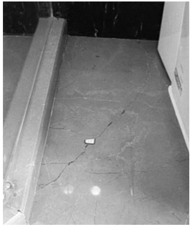
浴室地砖出现裂纹
